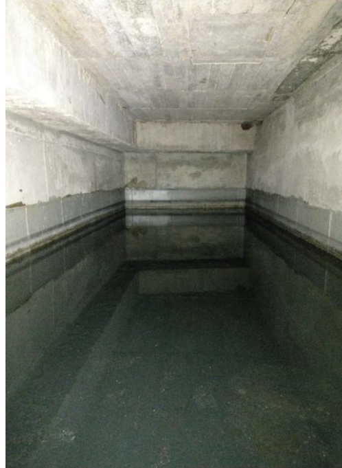
Imagen No.4 Tanque de almacenamiento aguas lluvia.
