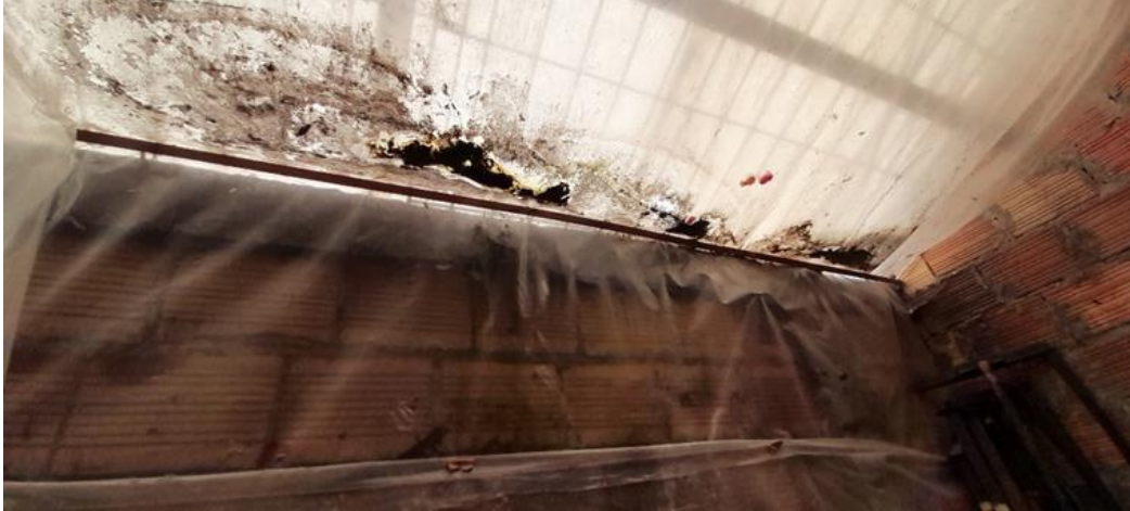
Fotografía 3. Reparaciones locativas inadecuadas y temporales. Alcaldía Local de Usme.
