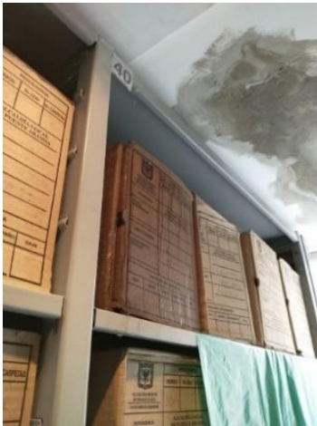
Fotografía 1.. Detalle de la documentación que recibió humedad directa. Alcaldía Local de Puente Aranda.
