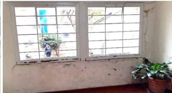
Fotografía 4. Muros con problemas estructurales y de humedad
